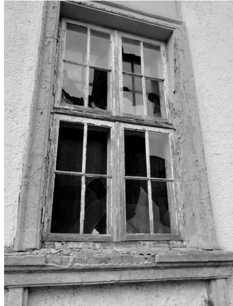
Abb. 2.4 Broken Window : erster Schritt zum Verfall ganzer Stadtviertel. Foto: Niteshift (Wikipedia, CC BY-SA 3.0)
