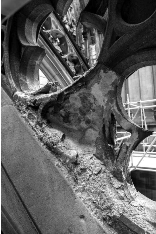
Abb. 2.2 Kölner Dom: Verwitterungsspuren an einem Strebebogen (Südquerhaus) aus Schlaitdorfer Sandstein. Foto: Jennifer Rumbach. Mit freundlicher Genehmigung © Hohe Domkirche Köln, Dombauhütte
